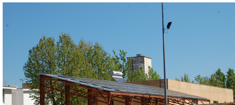
Instalación fotovoltaica sobre la grada del campo de fútbol.
